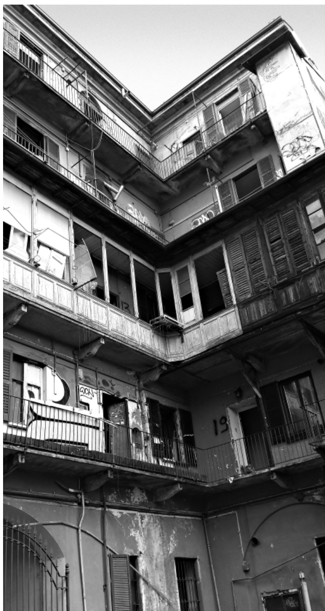
Il degrado e l'abbandono del cortile interno dello stabile
